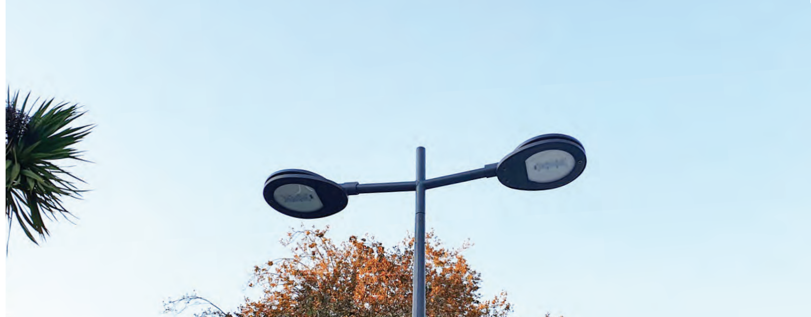
Iluminação Pública no centro, S. João da Madeira, Portugal Center's Public Lighting, S. João da Madeira, Portugal
